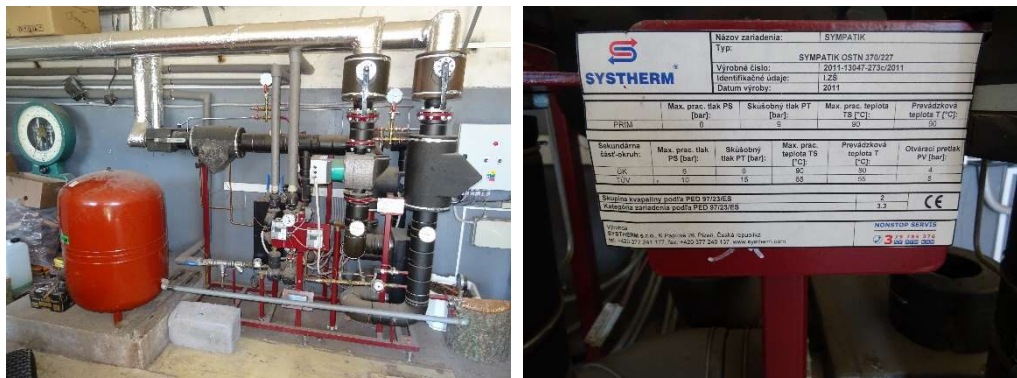
Obr. 16: Zdroj tepla – výmenníková stanica
